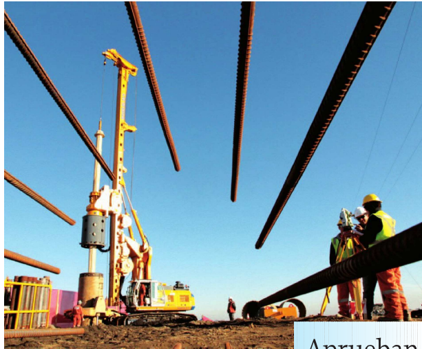
Esta semana se inició a un costado de la Ruta Interportuaria el hincado de pilotes para el paso sobre nivel "Los Budes".
